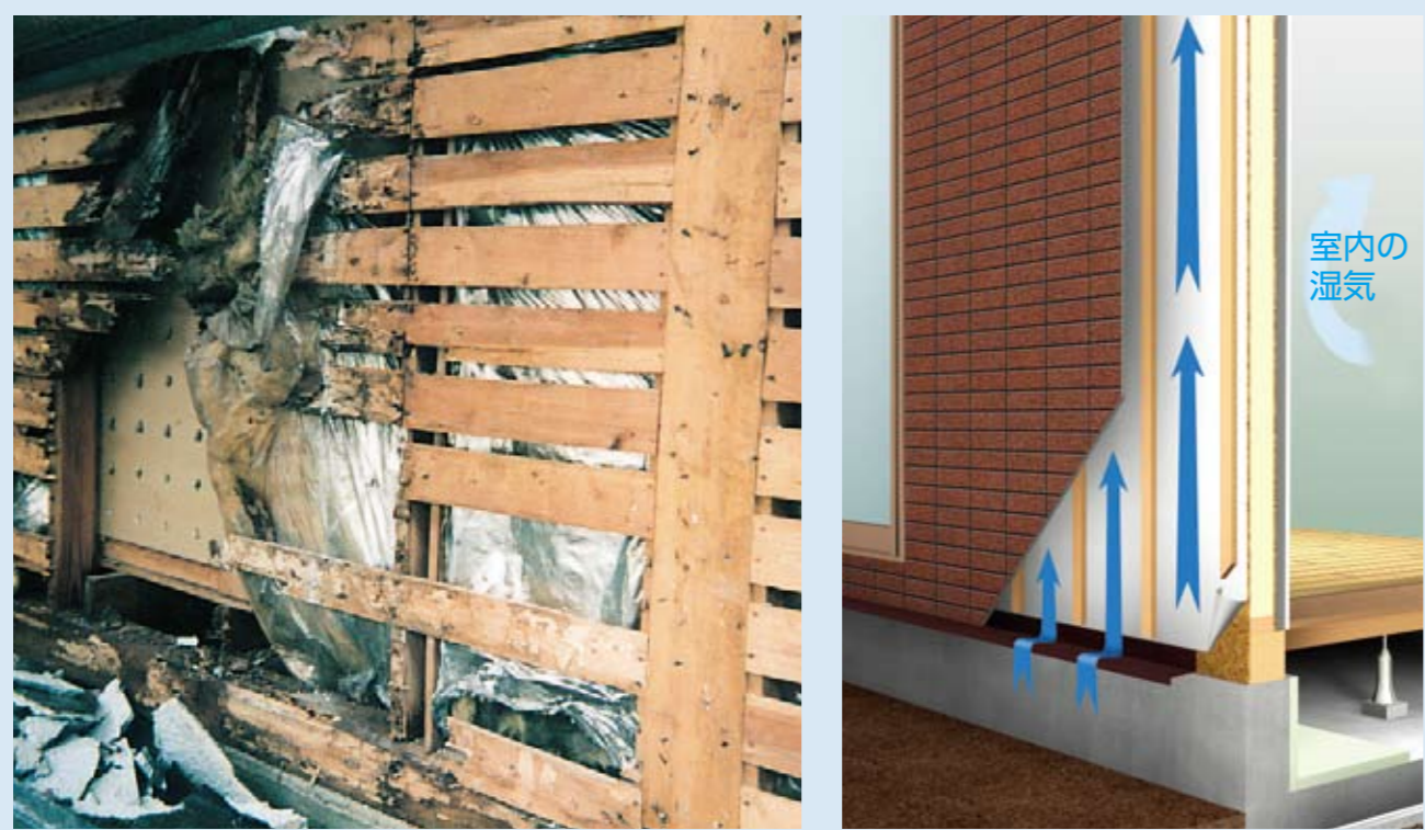
一般住宅の壁内部の損傷例
